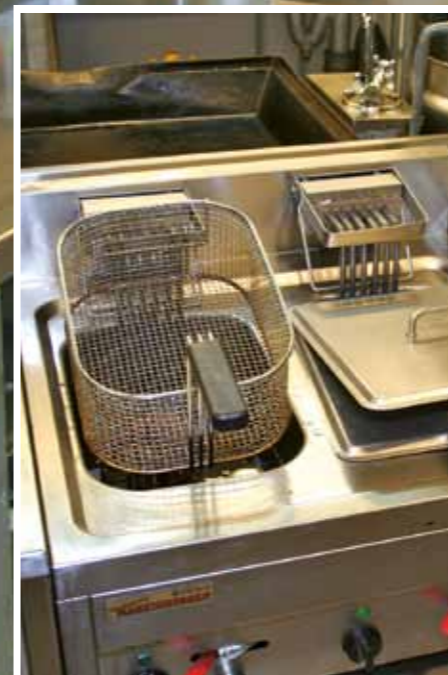
Rasv ja lõhnad ventilatsioonitorudes võivad põhjustada probleeme nii ventilatsioonisüsteemile kui ka hoone teistele asukatele.
